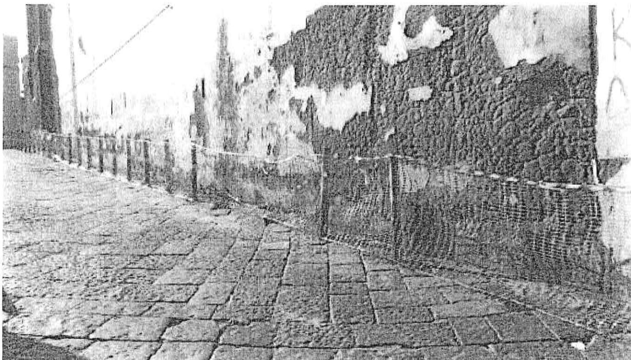
1_Facciata laterale, distacchi di intonaco
